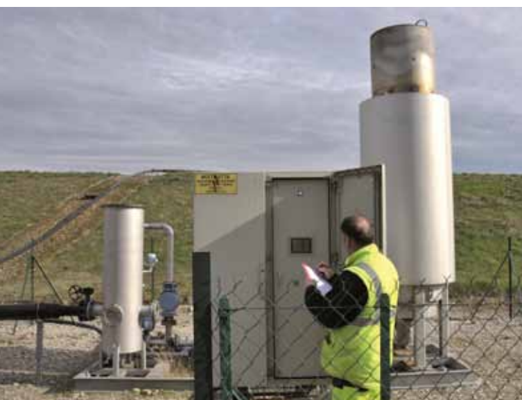
Station de traitement du biogaz
