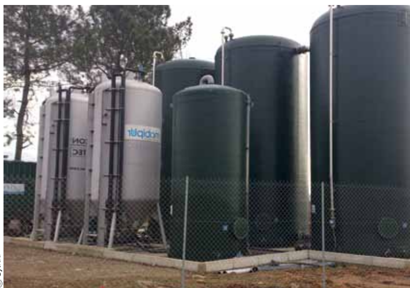
Station de traitement des lixiviats
